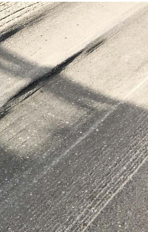
Spurrinnenbildung auf einem Asphaltbelag infolge des Schwerverkehrs und hoher Temperaturen.
