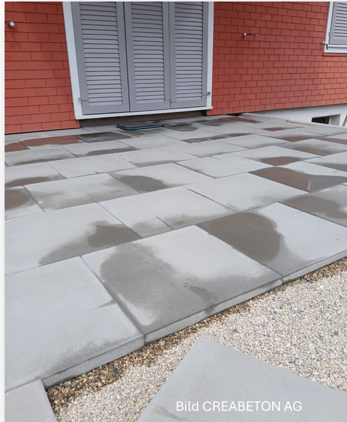
Risse an Plattenkanten
