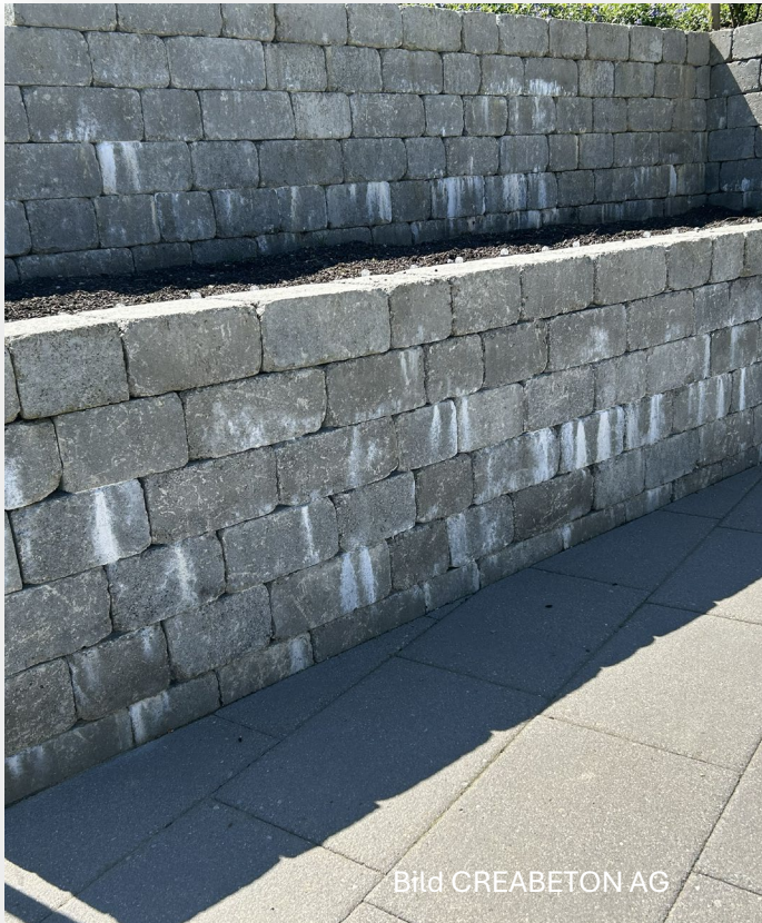
Ausblühungen bei Betonmauern
