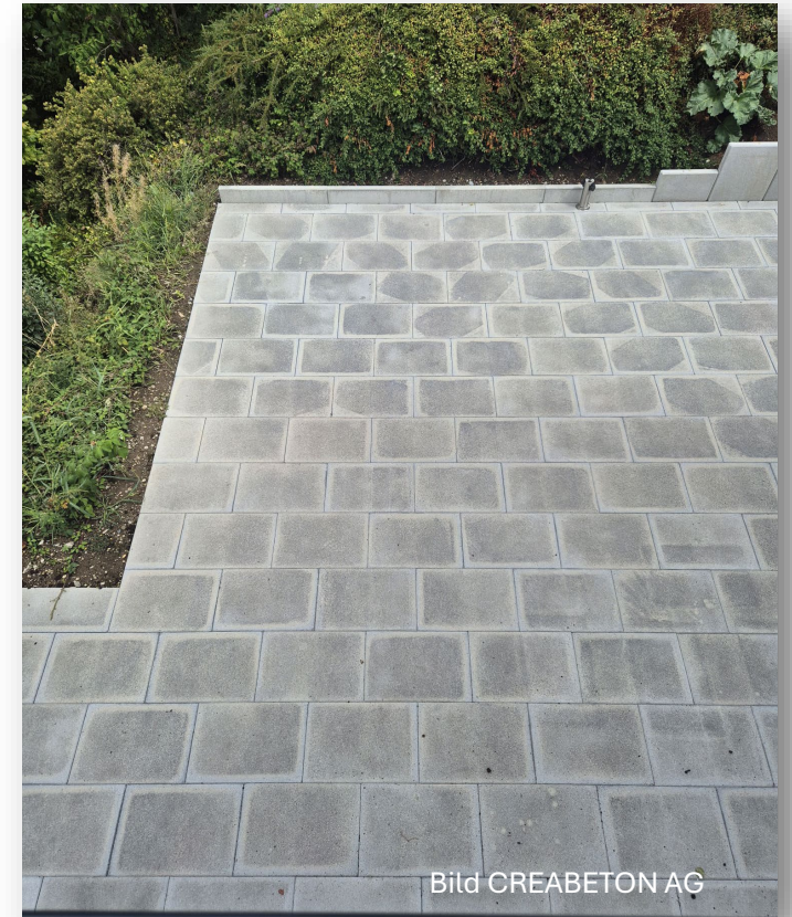
Verfärbungen infolge diverser Rahmenbedingungen
