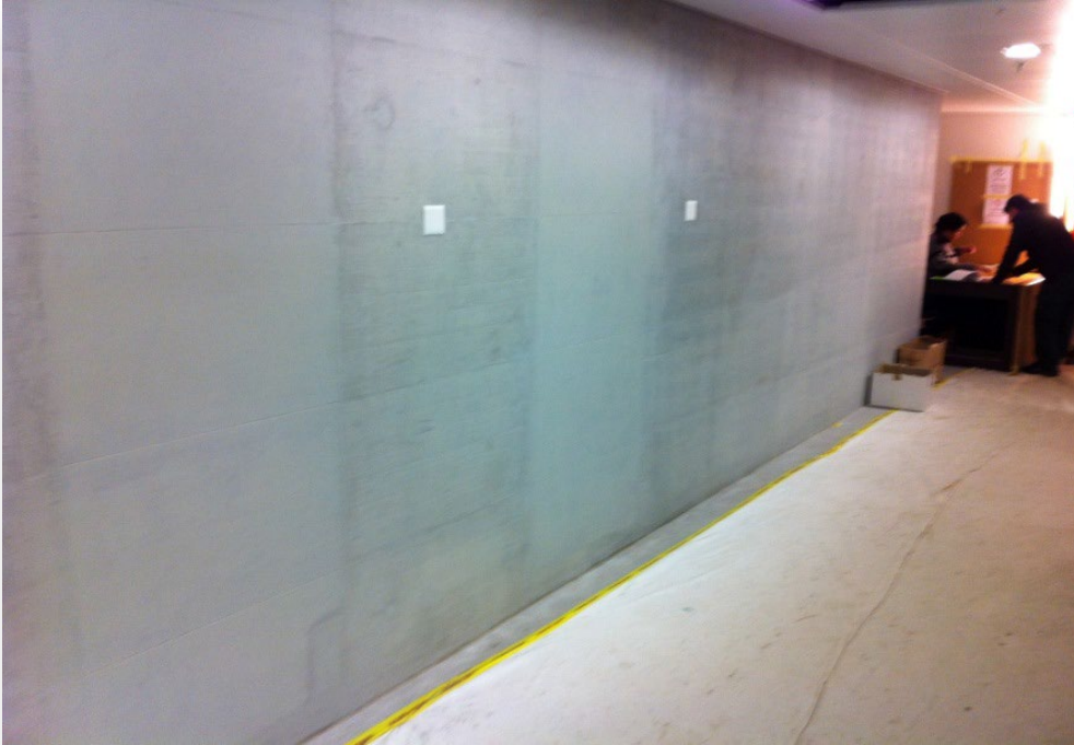
Falsch geplante Türöffnungen
