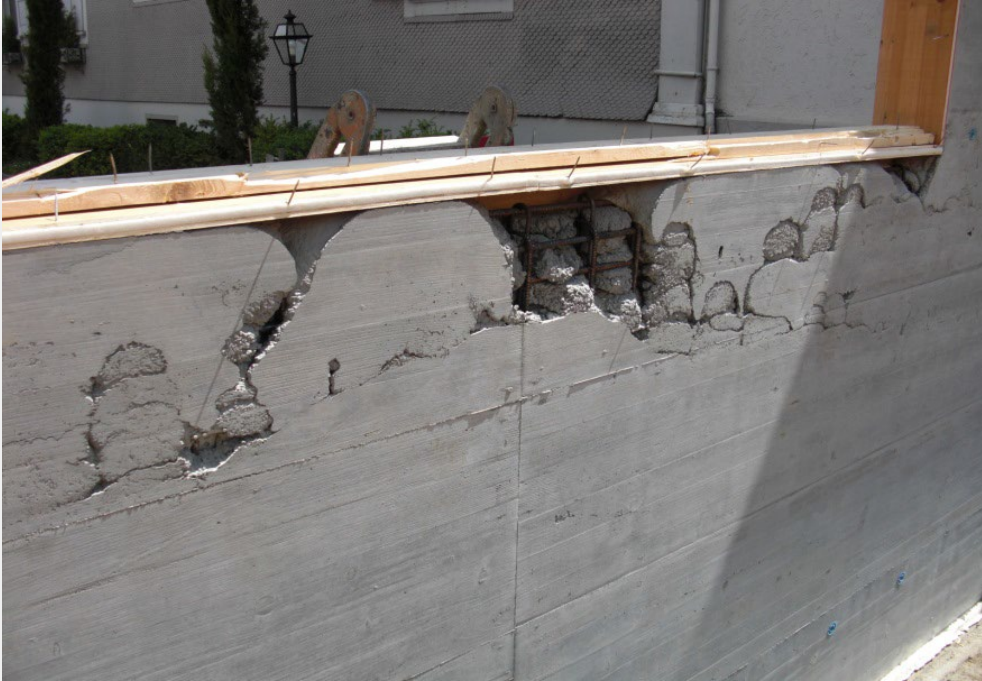
Schlecht hinterfüllte Fensterbrüstung
