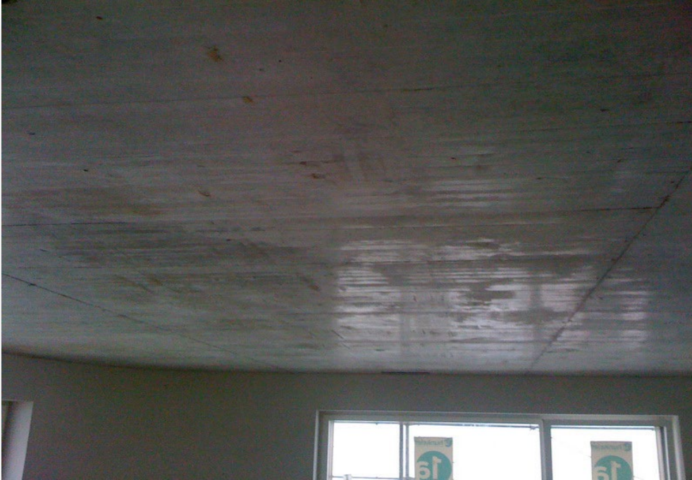
Glanz-Matt-Spiel infolge einer Sinterhaut an einer Sichtbetondecke
