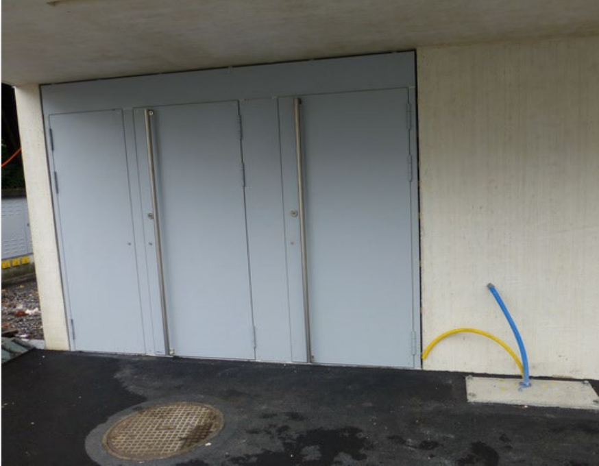
Metalltür angrenzend an Sichtbetonwand Schalung mit Matrize beplankt
