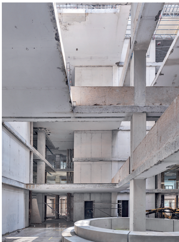
Fig. 4 Der Innenhof vor dem Ausbau. The atrium before the extension. (© René Dürr, Zürich)
