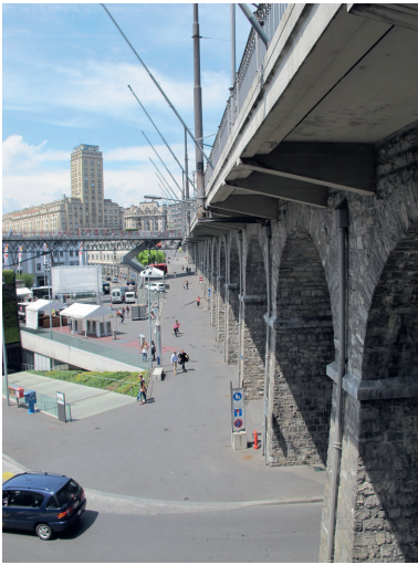
Fig. 2 Vue de l'élargissement de 1933 avec les sommiers en béton. View of the 1933 extension with concrete transverse beams.
