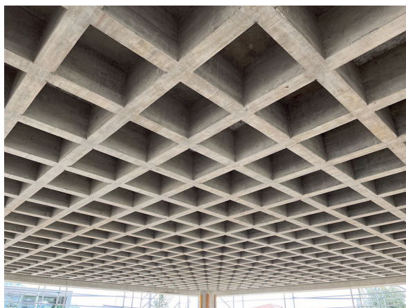
Fig. 9 Il campo quadrato grande del solaio a cassettoni in fase di cantiere. The large square area of the coffered slab during construction.
