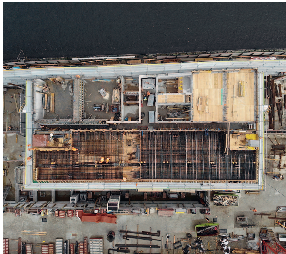
Fig. 6 Hochhaus Nord. Erstellung der ins Hochhaus hineinragenden vorgespannten Depotdecke über OG2. North tower. Construction of the post-tensioned depot slab extending into the high-rise structure above Level 2.
