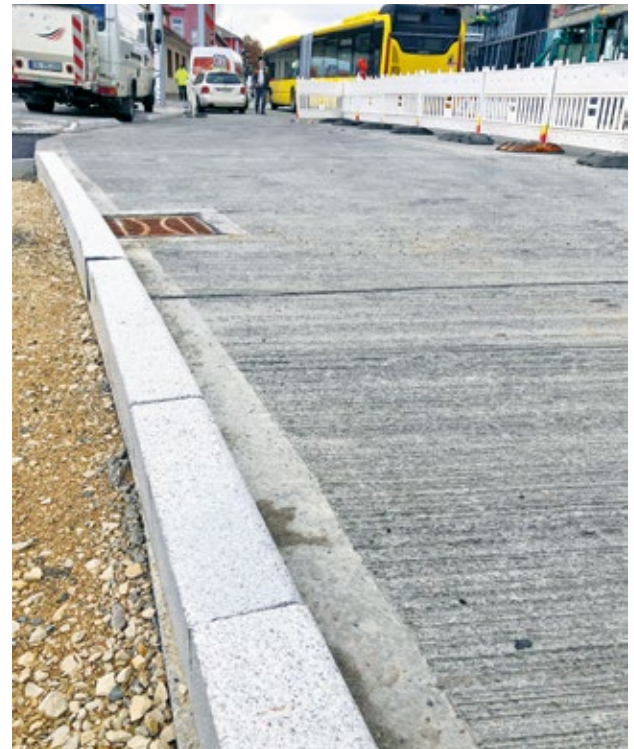
Klebeborde auf kugelgestrahlter Betonoberfläche
