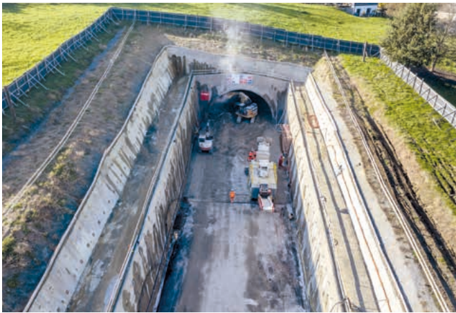
Le portail sud « Stumpfen » montre à quel point la couverture du tunnel de Städtlerwald est faible.
