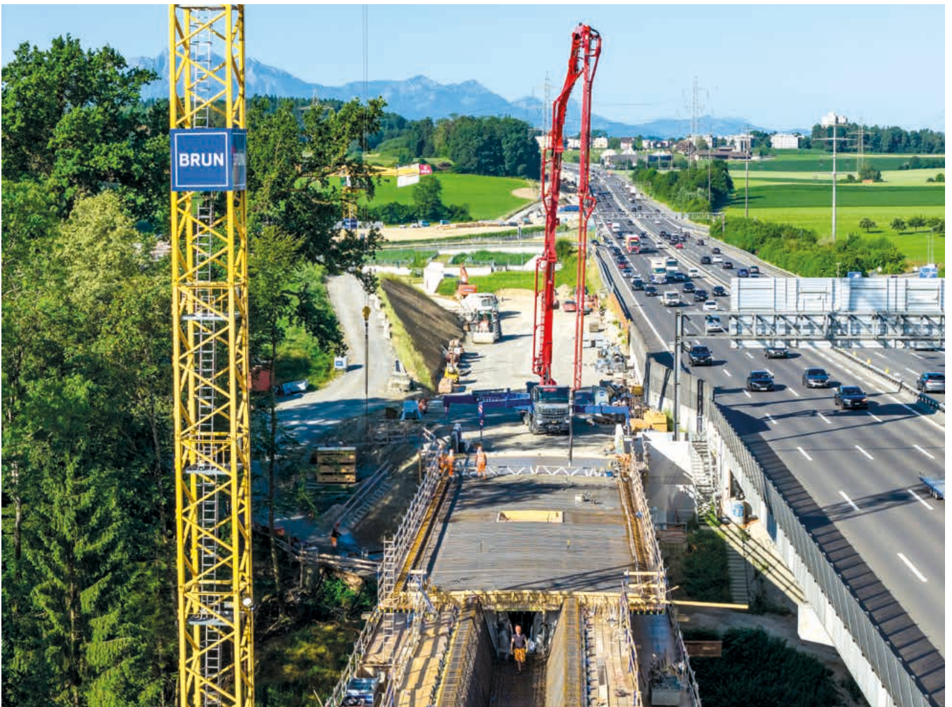
Bétonnage du tablier du pont de Lorzental 3 : sur le bord inférieur de la photo, on peut encore distinguer le caisson en V.
