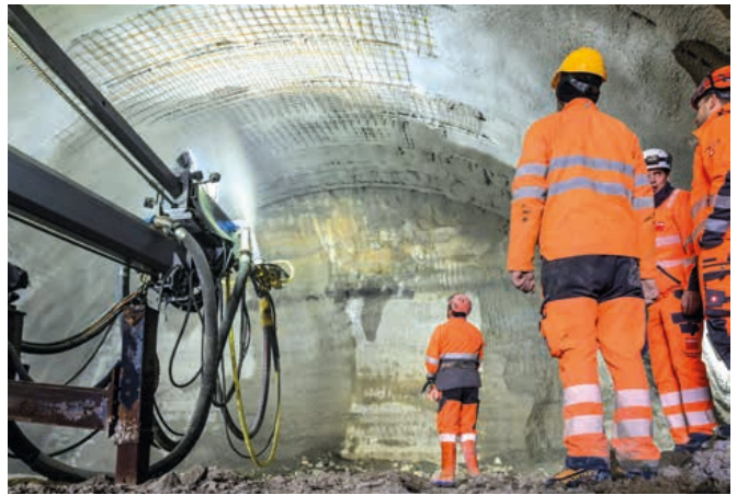
La voûte du tunnel est renforcée par des armatures et du béton projeté.
