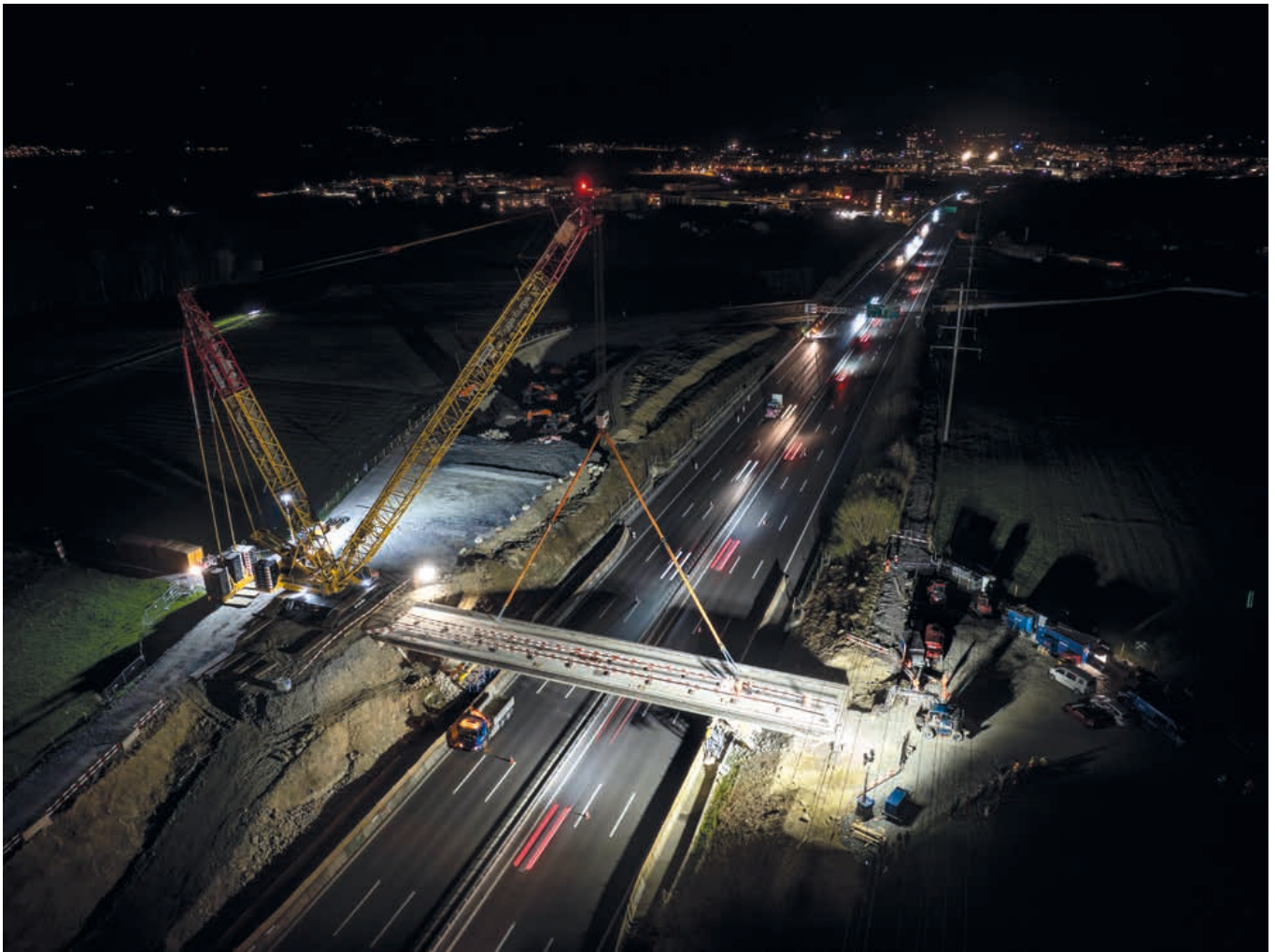
Le pont autoroutier d'Eret a été découpé en bandes longitudinales lors d'une opération de nuit en avril 2025, soulevé et déplacé à l'aide d'une grue sur chenilles à mât treillis.
